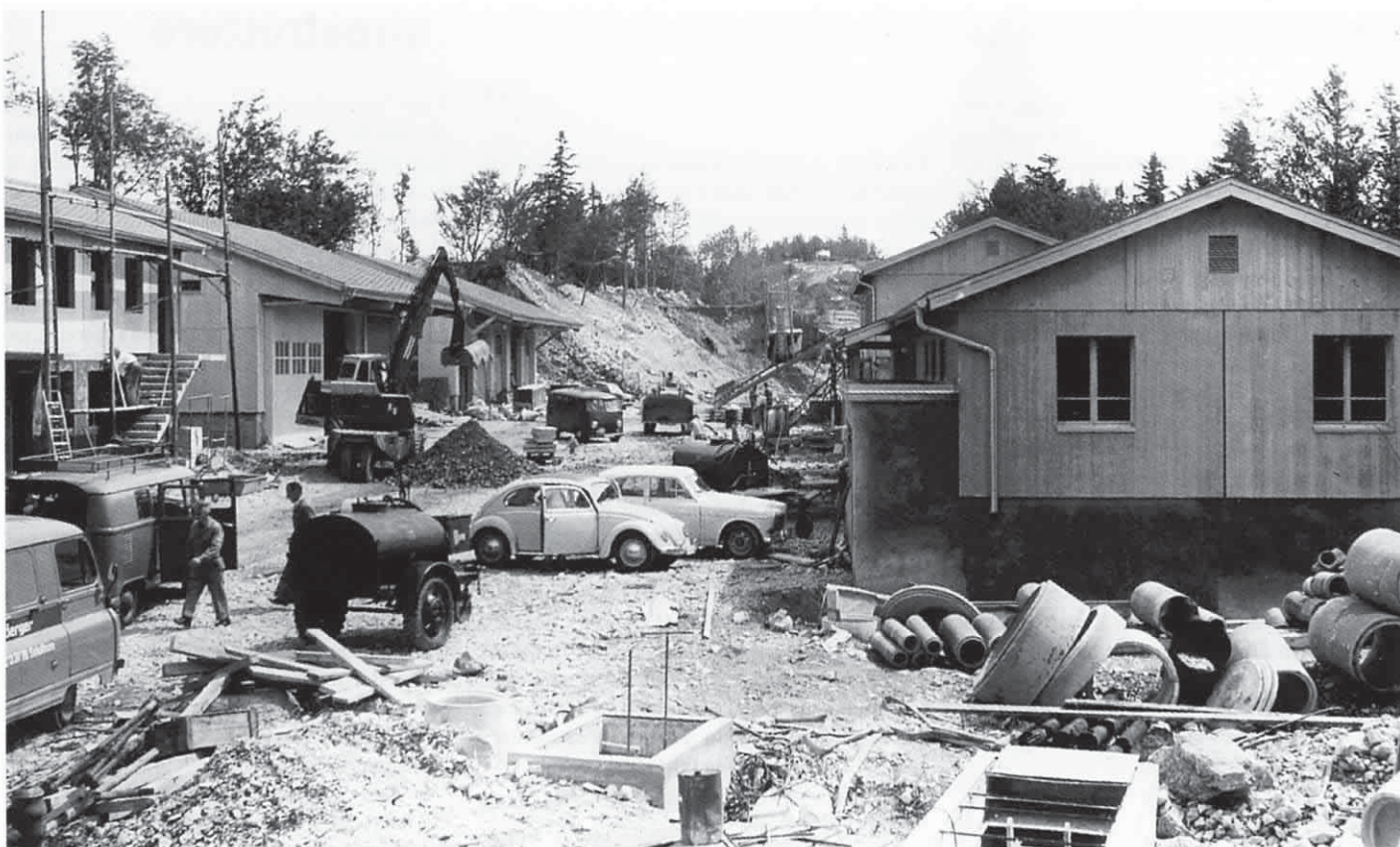
Baustelle auf einer Lenkwaffenstellung / Construction d'une position de missiles sol-air / Costruzioni sulle postazioni per i missili teleguidati
